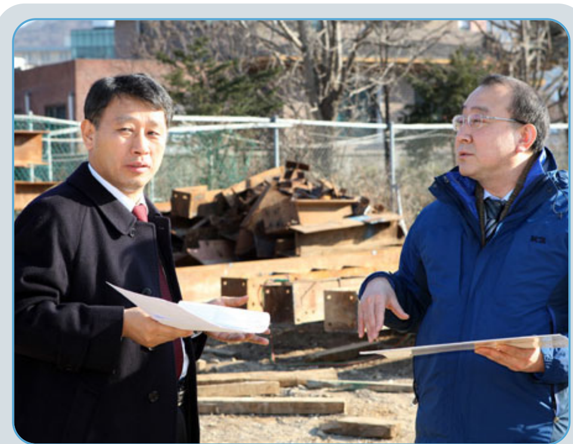
김광재 이사장은 지난 12월 23일 상록수역 교각하부 시민쉼터 조성지 및 경부고속철도 개착부 사용허가지 현장을 방문, 자산 활용을 통한 수익창출 등 종합적인 개선대책에 대해 의견을 나누었다.
