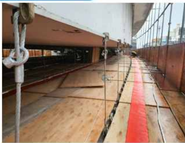
① 기존 설치 된 방호선반 내부
