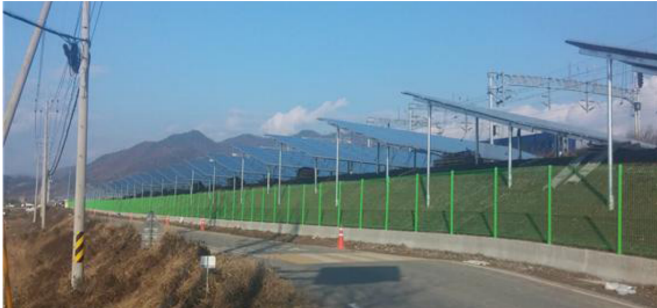
[영남권 관내 태양광 발전사업 추진현황]
