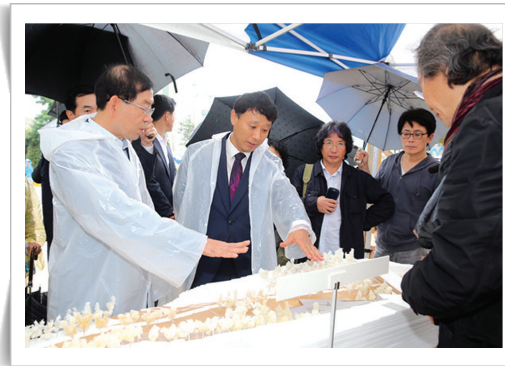
김광재 이사장은 10월 8일 서울 마포구 새창고개(백범교)에서 박원순 서울시장, 지역 국회의원 및 주민 등 200여 명이 참석한 가운데 '경의선숲길 공원조성사업 2단계 구간' 착공식을 가졌다.
