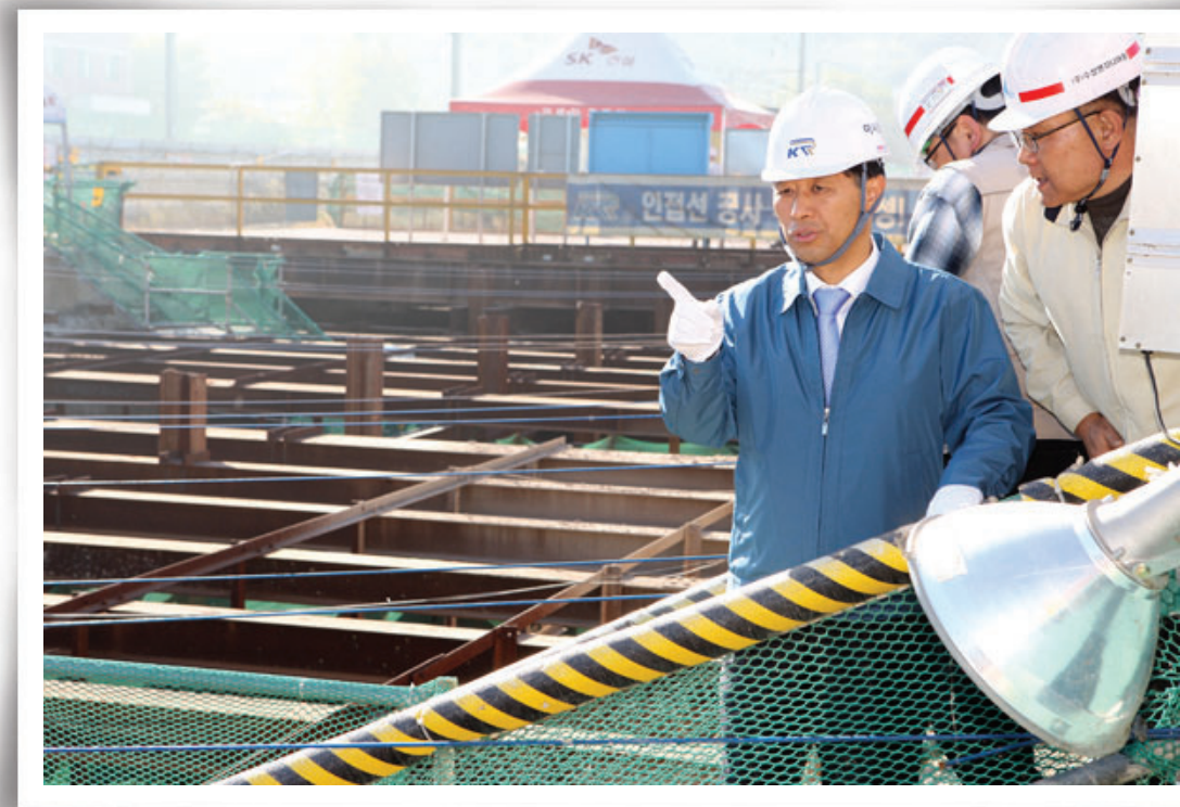
김광재 이사장은 지난 18일 경부고속철도 대구도심구간 등 영남본부 관내 건설현장을 시찰하며 적기개통에 차질이 없도록 안전을 다해줄 것을 당부했다.
