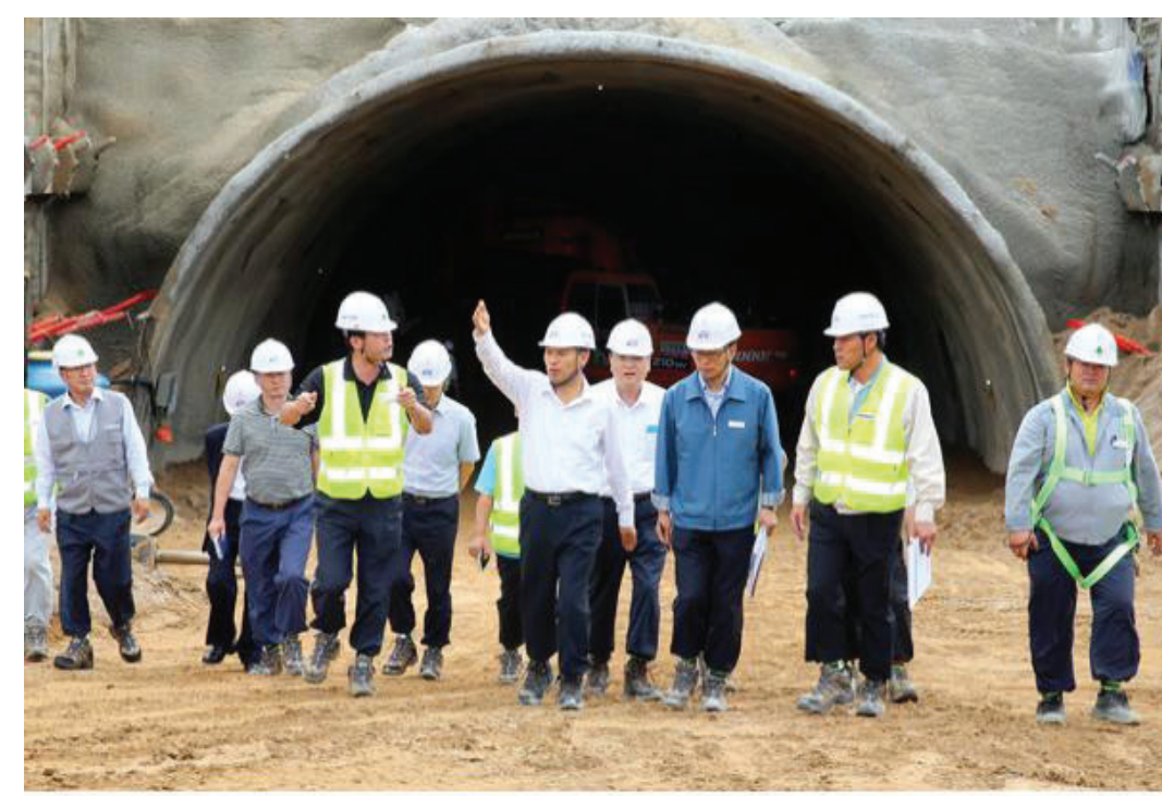
김광재 이사장은 8월 23일 원주~강릉 철도건설 현장 등 강원본부 건설현장을 방문하여 2018년 평창 동계올림픽의 성공적 개최를 지원하고 강원지역 발전에 기여할 수 있도록 최선을 다할 것을 당부했다.
